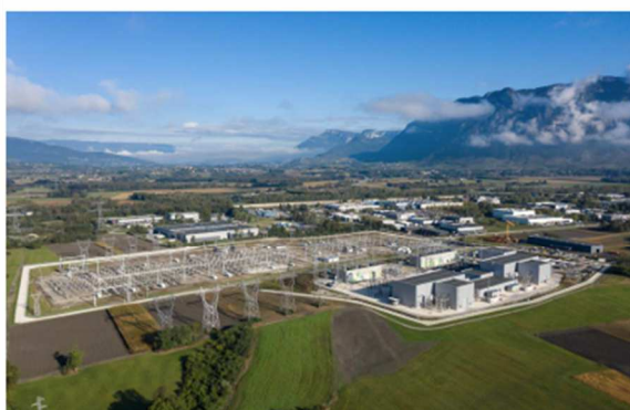
Exemple de station de conversion, Interconnexion avec l'Italie (Savoie)
