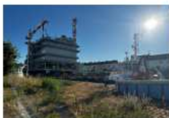
Départ de la sous-station depuis St-Nazaire
