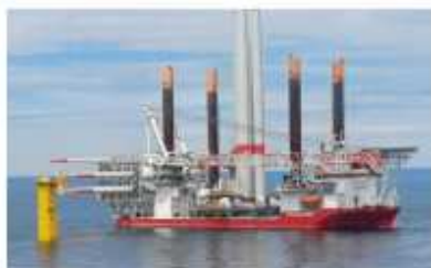
Navire : Voile au Vent Chargement à St-Nazaire 4 turbines par cycle
